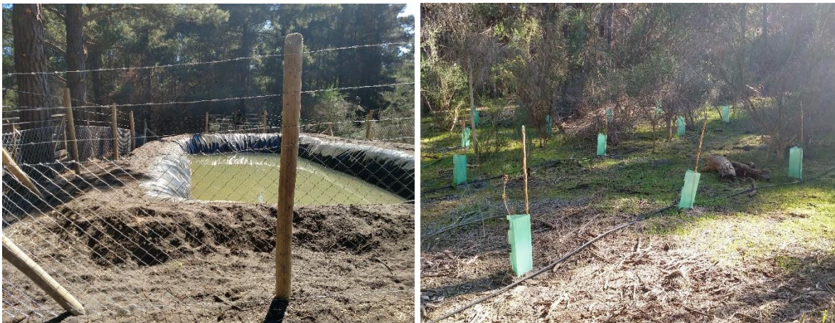
Figura 5. Sistema de riego por goteo instalado. A la izquierda se observa el estanque de acumulación de 20.000 litros. A la derecha se observan las líneas de riego.
